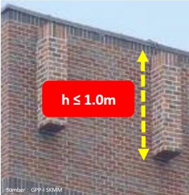
Panel pemancar komunikasi dipasang pada dinding bangunan dan disesuaikan dengan warna fasad bangunan
