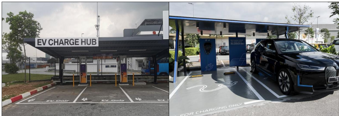
Foto 5.6 : Contoh Stesen Pengecasan EV yang Telah Disediakan di Malaysia
