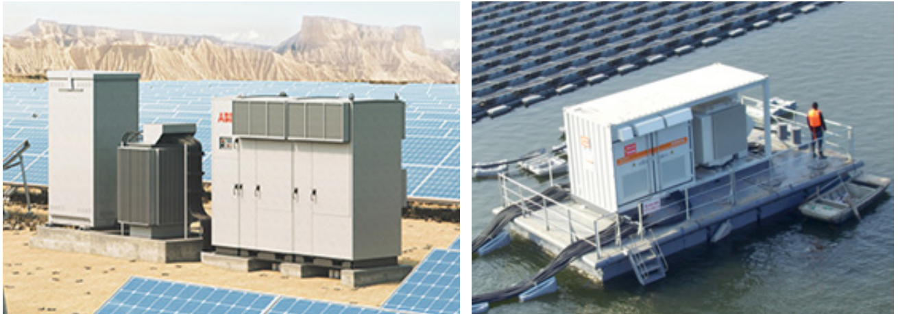
Foto 7: Centralised inverter ladang solar atas tanah dan atas permukaan air
