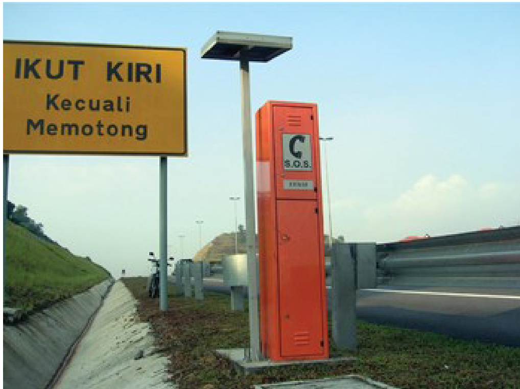
Foto 33: Contoh telefon kecemasan menggunakan tenaga solar
