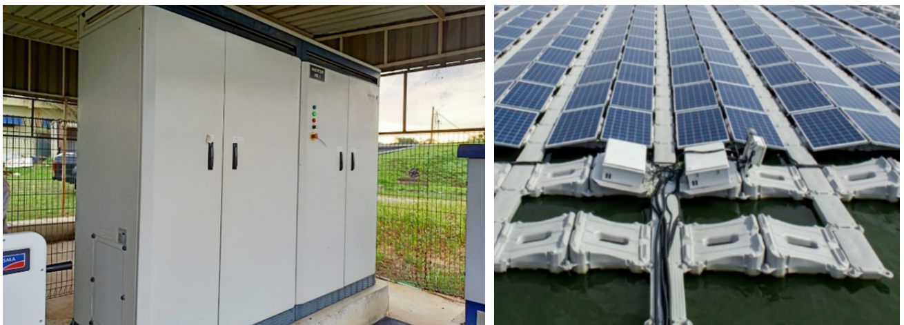
Foto 8: String inverters ladang solar atas tanah dan atas permukaan air
