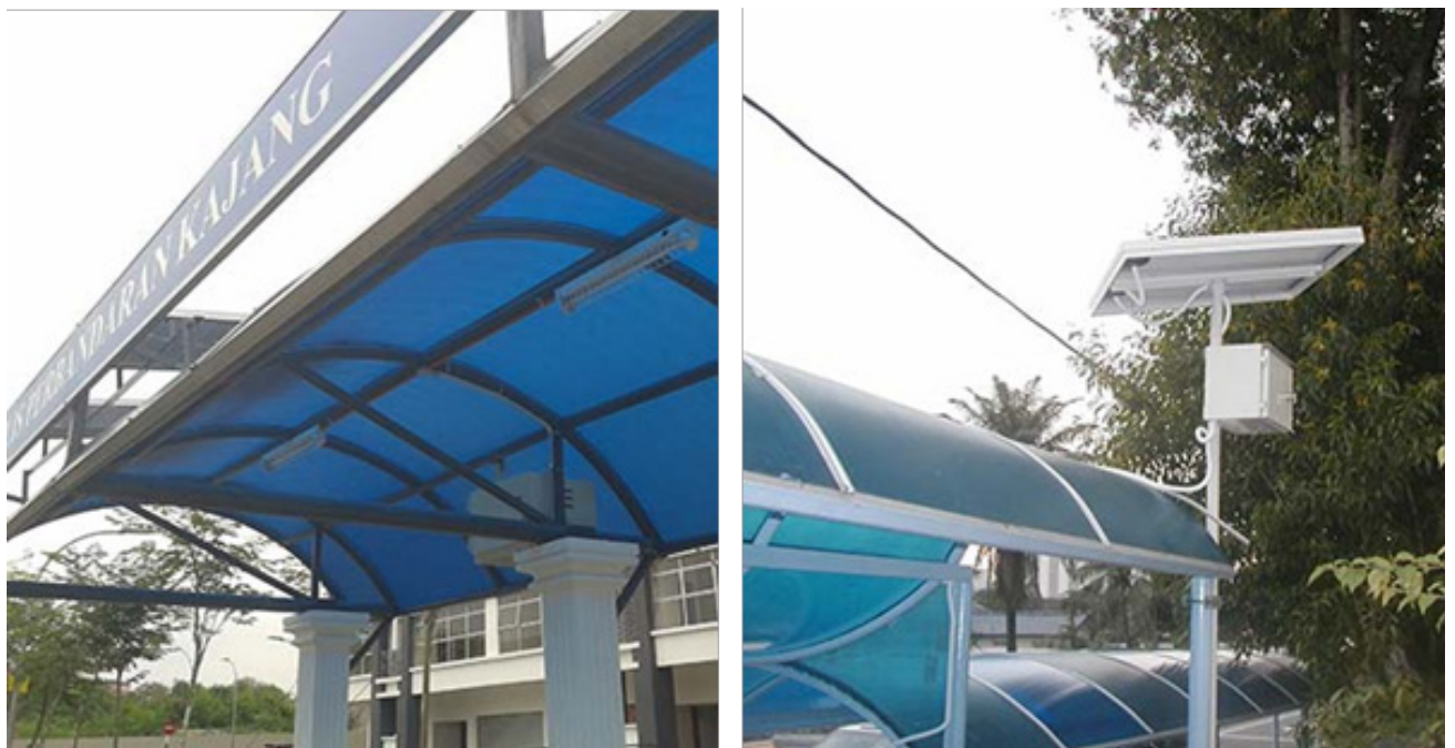
Foto 29: Penjanaan solar bagi pencahayaan di hentian bas
