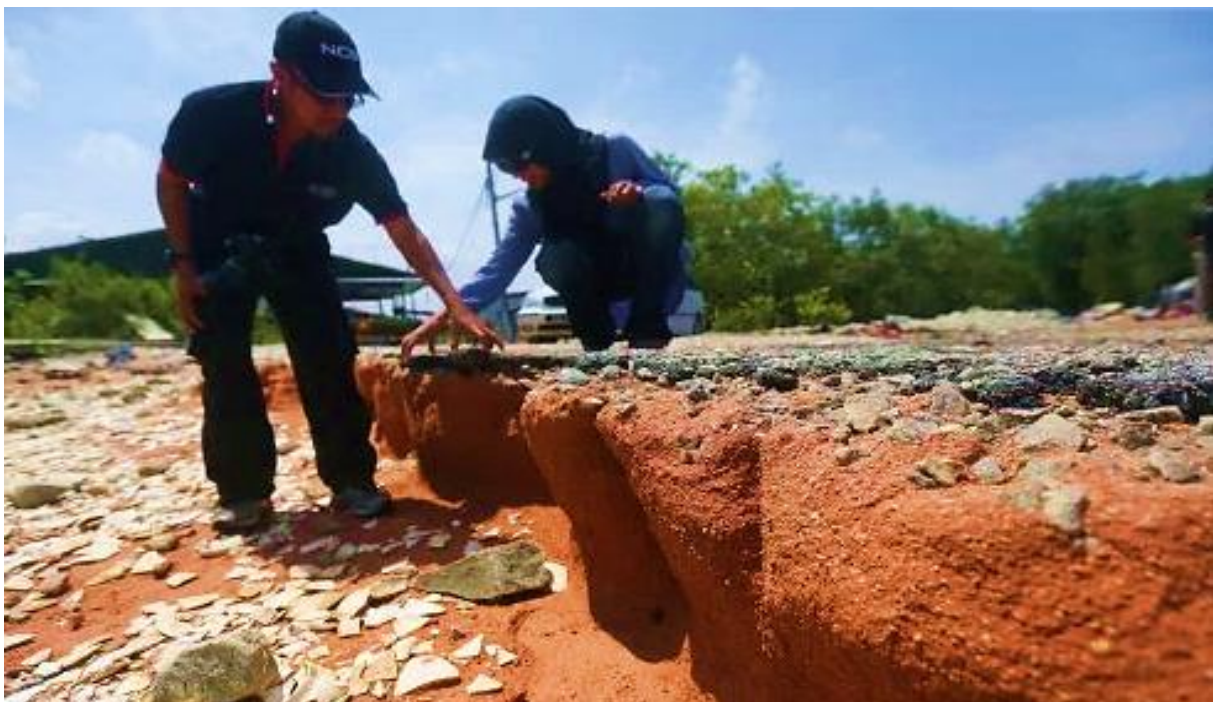
Foto 2.43: Kawasan persisiran pantai yang terkesan akibat kenaikan aras laut di Kuala Batu Pahat, Johor
