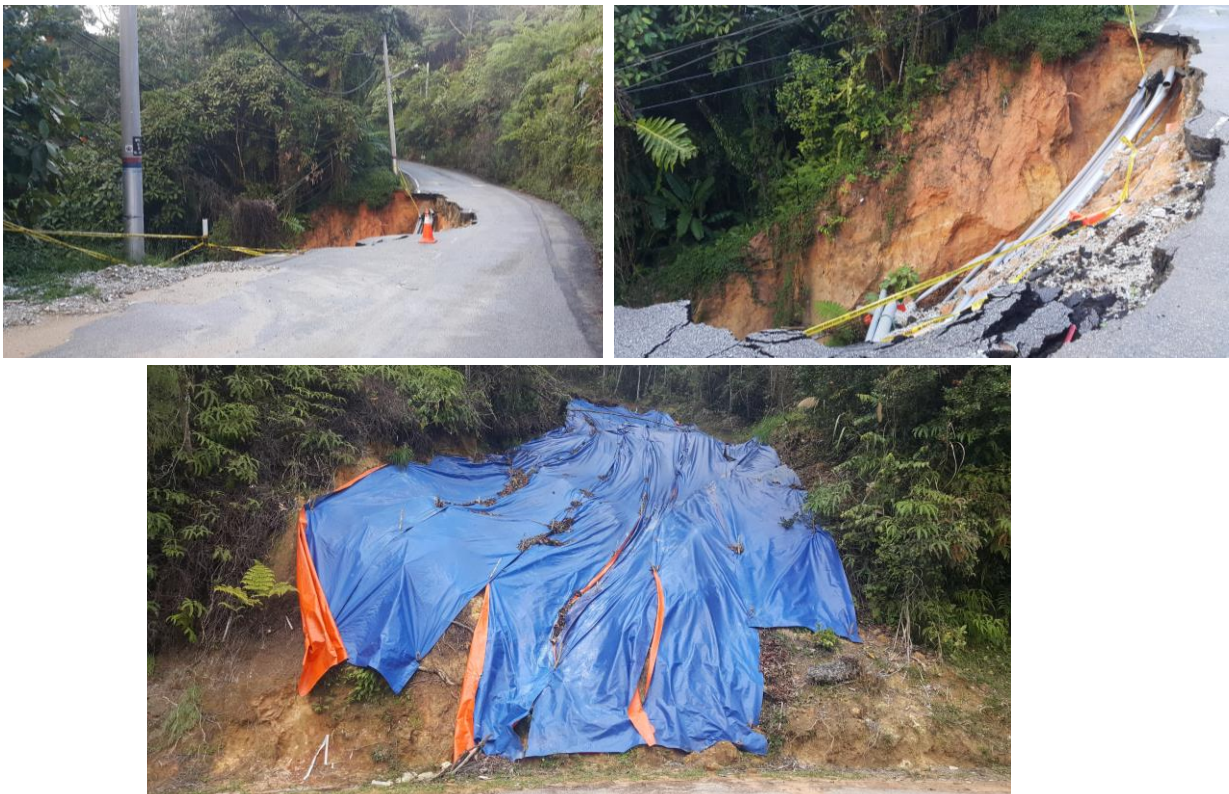
Foto 2.17: Kejadian jalan runtuh menuju ke Brinchang
