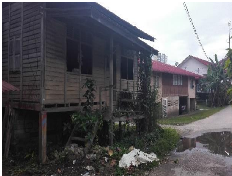
Foto 2.2: Banjir mengakibatkan struktur rumah menjadi rosak
